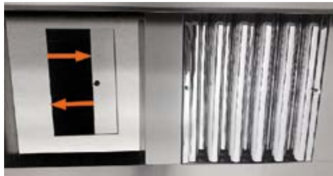
Plenum interior de aspiración con trampillas de Regulación de caudal filtro a filtro
