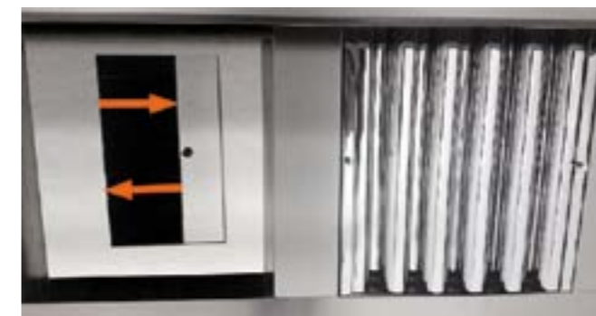
Plenum interior de aspiración con trampillas de Regulación de caudal filtro a filtro
