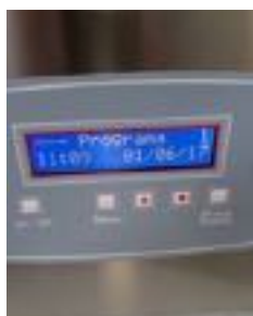
Detalle Panel Mandos BV
